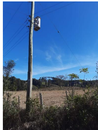
Figura 3: Rede elétrica disponível no local.
